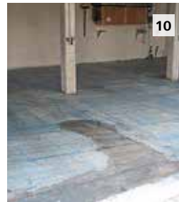
10 Rauer Untergrund mit Ausbruchstellen und Rissen nach dem Grundieren mit StoCryl EH 100
