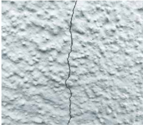
Risse, die zur Kostenfalle werden können
