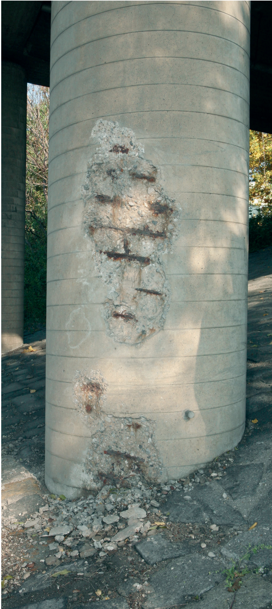
Pilastro del ponte danneggiato dalla corrosione indotta dal cloro.
