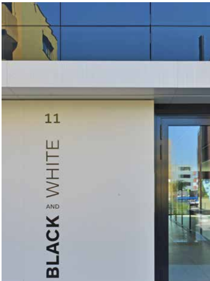
Transition entre les panneaux photovoltaïques à fixation invisible et la façade
