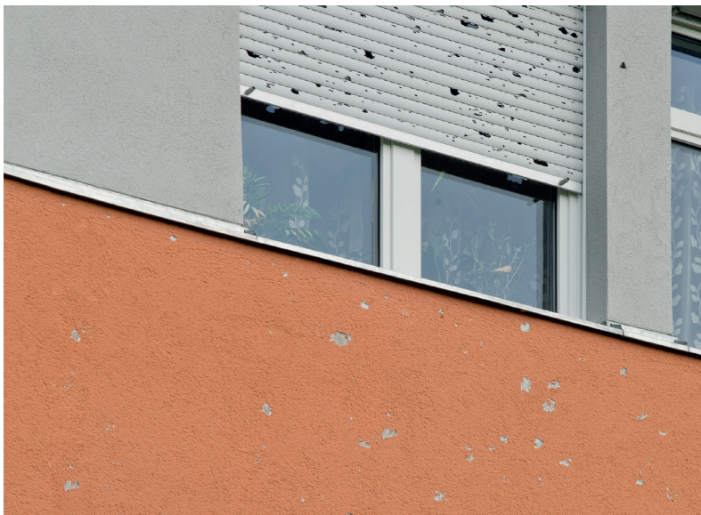
Photo du haut : là où les grêlons ont frappé, ils ont laissé des dommages visibles sur la façade. Une rénovation ciblée est désormais nécessaire pour restaurer la protection et l'aspect de la façade.
