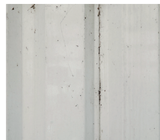
Surface avant le nettoyage
