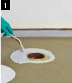
1 Sichtbarer Flansch des Bodenablaufs
